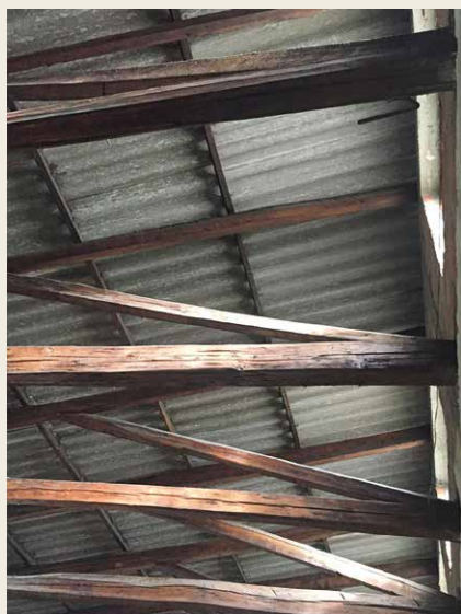
En obras para talleres y sitios de trabajos, Manrique Martín utilizó cerchas simples, en madera local. Es el caso de los talleres para el almacén Casa Mettler, localizado en el centro tradicional de la ciudad de Pasto en Nariño. Foto: Juan Álvaro Rojas, 2016.
